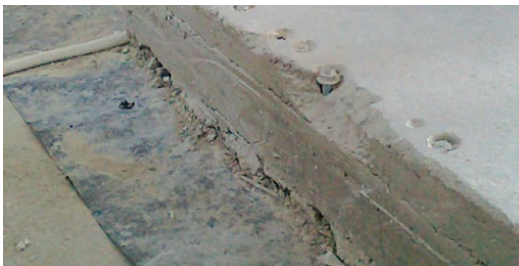
Nieudane próby naprawy i mocowania śrubami stopnia schodów z płytą grzewczą
