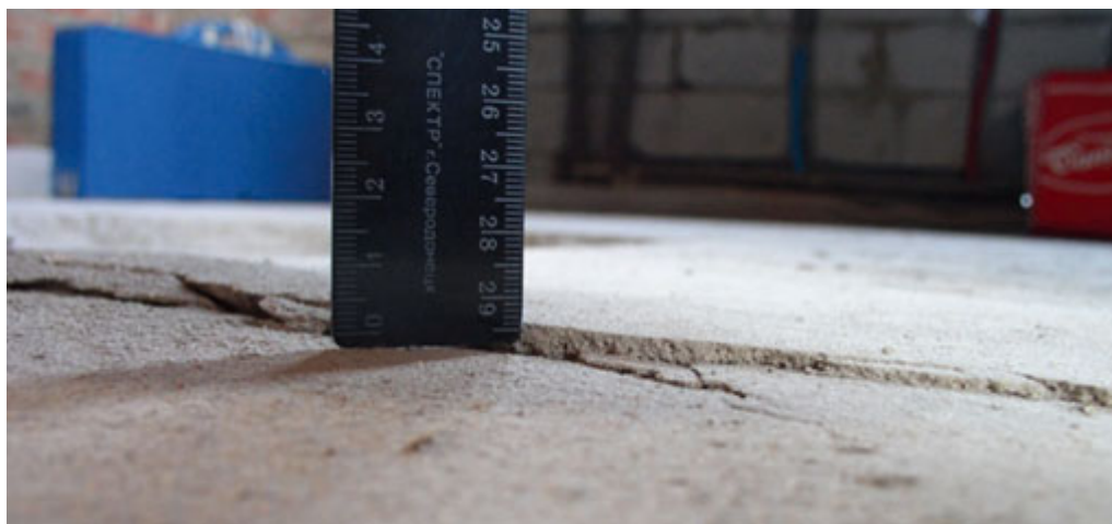
Efekt błędu - wypiętrzenie się płyt grzewczych na ogrzewaniu podłogowym
