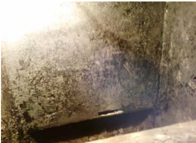
Fot. 4. "Korozja niskotemperaturowa" wymiennika, brak zabezpieczenia zaworem mieszającym.
