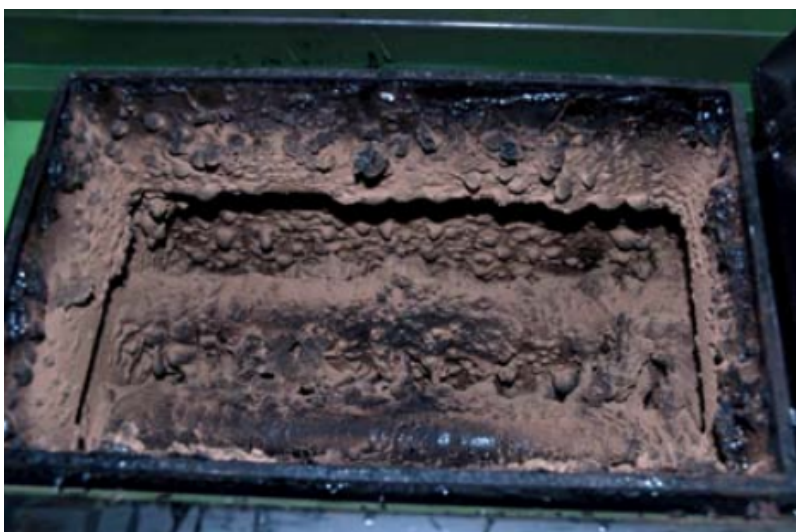
Fot. 3. Zabrudzenie wymiennika kotła - palenie mokrym drewnem, za mały przekrój kominia
