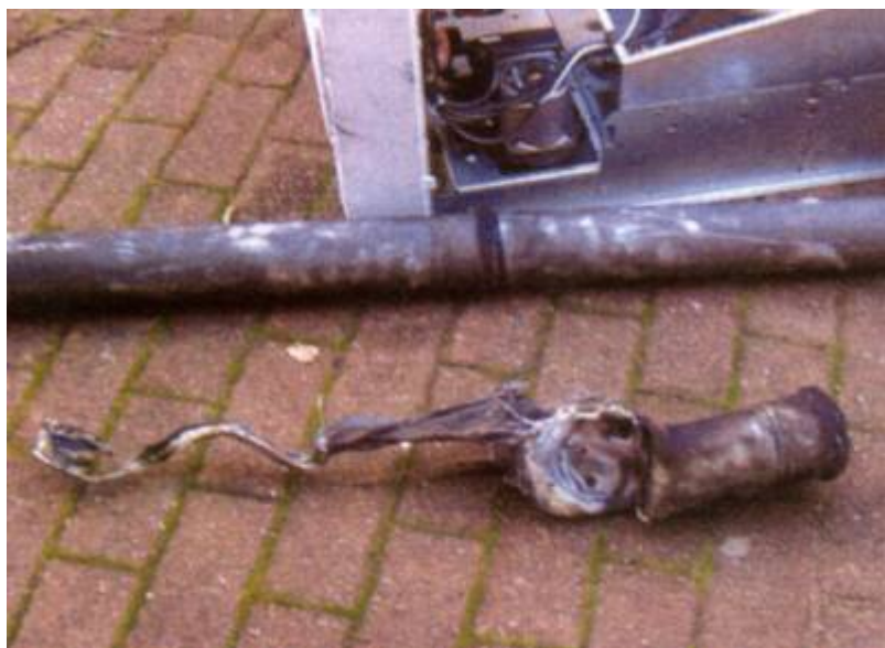
Rys.5 Spalony komin po awarii kotła
