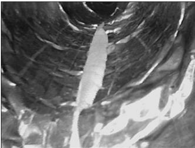
Rys.7 Uszkodzenie mechaniczne folii aluminiowej wewnątrz komina
