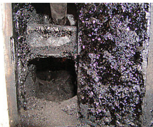
Wyczystka - efekt nie czyszczenia komina i palenia mokrym drewnem. fot. Jotul
