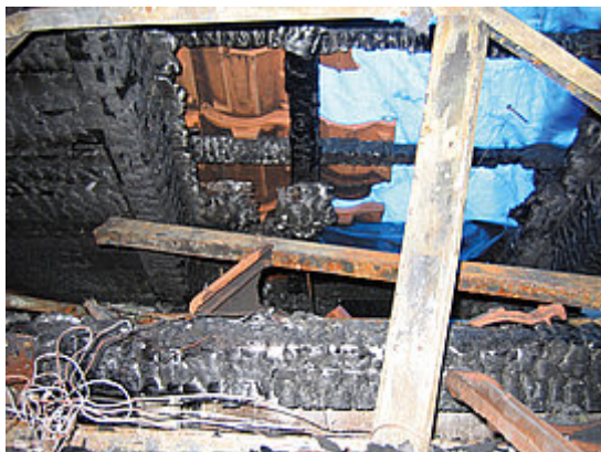
Skutki zapalenia się konstrukcji drewnianej domu. fot. Jotul
