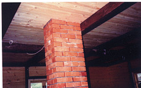
Zbyt blisko umieszczona belka drewniana w przypadku samozapłonu sadzy w kominku może doprowadzić do samozapłonu konstrukcji drewnianej domu. fot. Jotul
