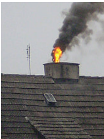
Pożar sadzy w kominie. fot. Jotul
